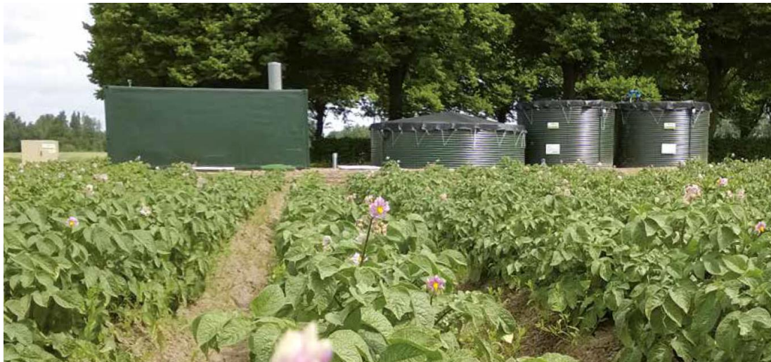
Figuur 9: Overzichtsfoto van het systeem voor ondergrondse opslag te Borgsweer.
